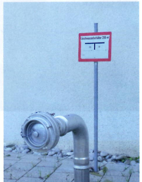
Kennzeichnung eines unterirdischen Löschwasserbehälters mit Mengenangabe.
